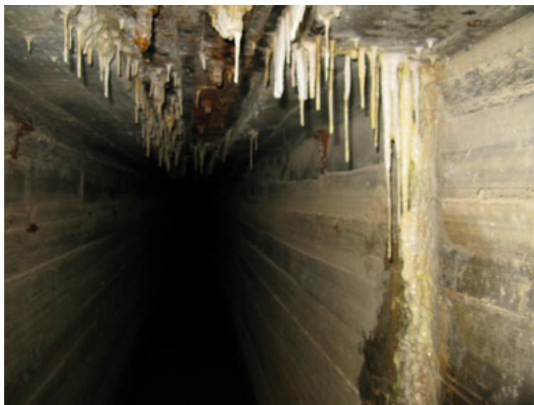
Рисунок 5.2 – Фильтрация воды с выносом гидроксида кальция через швы бетонирования и из-под потолочного уплотнения деформационного шва в соединительном коридоре между смотровыми шахтами верхнего и нижнего бьефов
