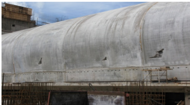
Рисунок 6.8 – Напорные водоводы гидроаккумулирующей станции:
