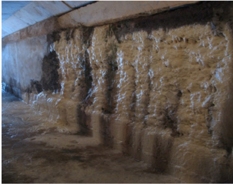
Рисунок 5.5 – Фильтрация воды по шву бетонирования между стеной и перекрытием потерны
