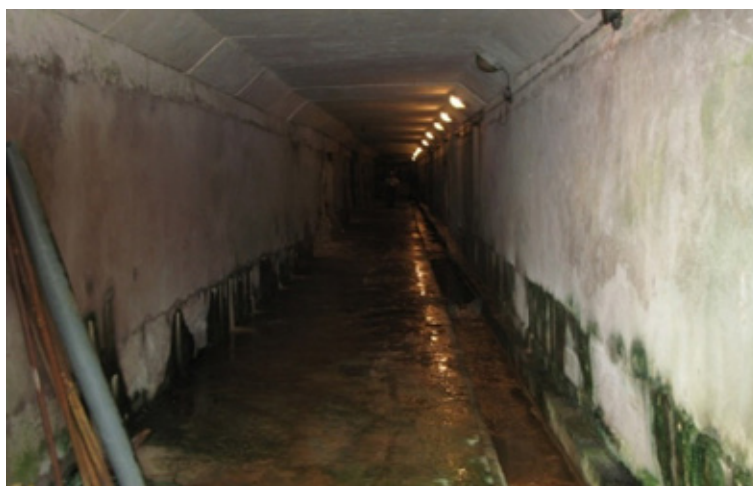
Рисунок 5.3 – Фильтрация воды в потернах бетонной плотины
