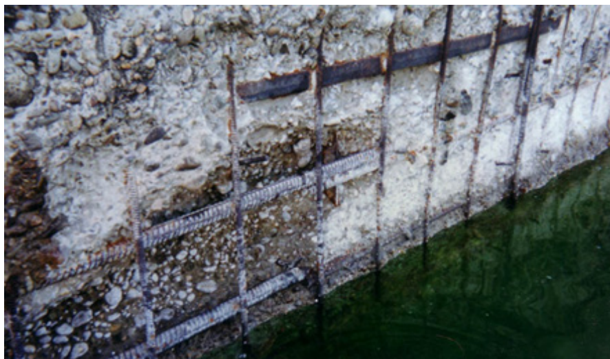
Рисунок 7.4.1 – Участок разрушенного бетона в зоне переменного уровня воды
