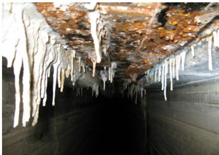
Рисунок 5.1 – Фильтрация воды через потолочное уплотнение деформационного шва с выносом гидроксида кальция и образованием «сталактитов» в соединительном коридоре между смотровыми шахтами со стороны верхнего и нижнего бьефов здания ГЭС
